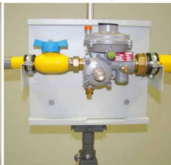
Фото 2 – Вид ШРП-НОРД 2 при снятом кожухе
